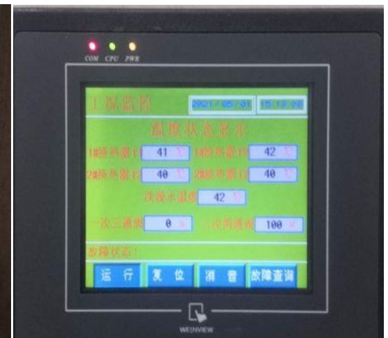
疏桐园 C 洗澡换热站
