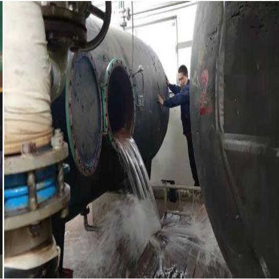
打开换热罐泄水、泄压
