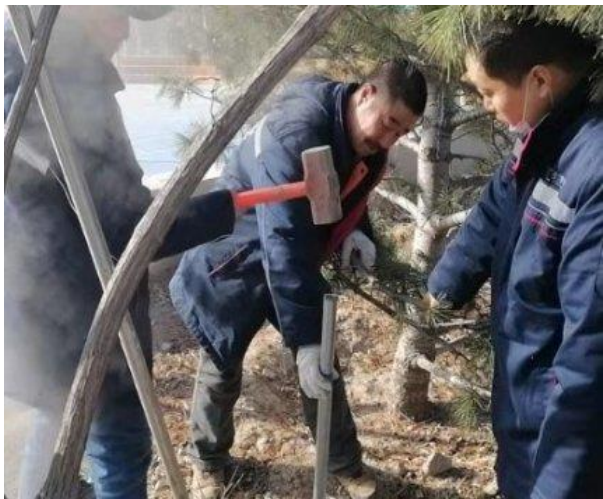
勘探确认篮球场北侧管道漏水
