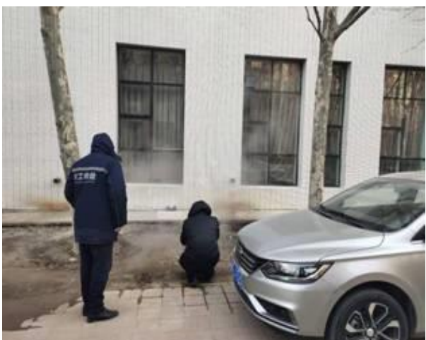
至善园北侧热力管道漏水
