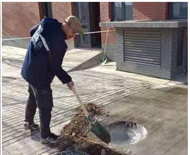
动力中心东侧热力管道漏水
