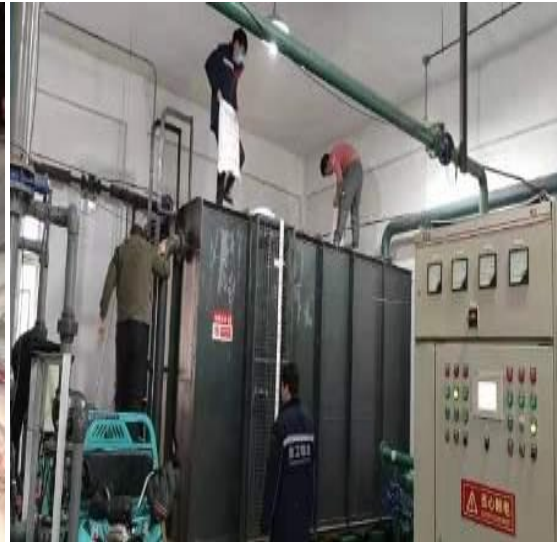
西区锅炉房水箱添加阻垢剂
