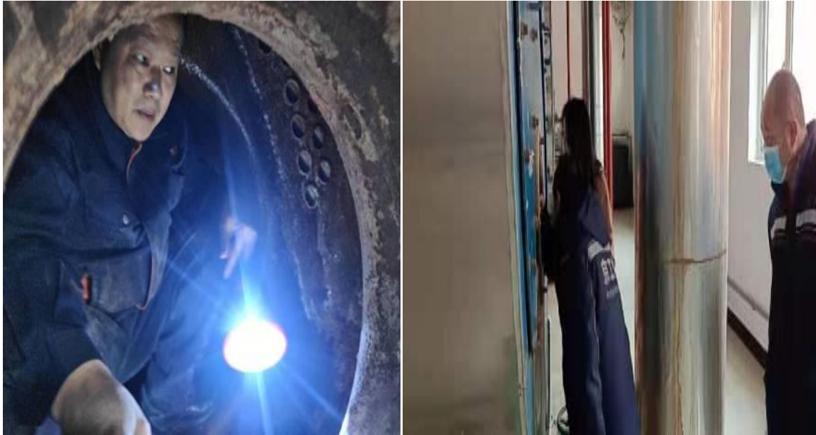
方仕顺排查 2#锅炉漏水情况
