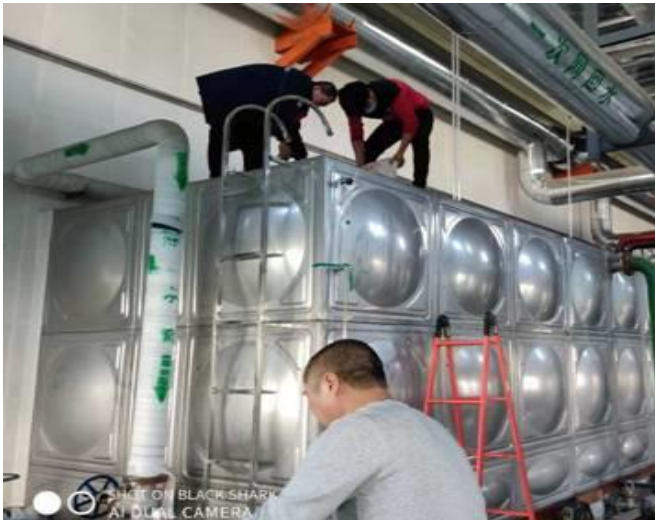
东区锅炉房水箱添加阻垢剂
