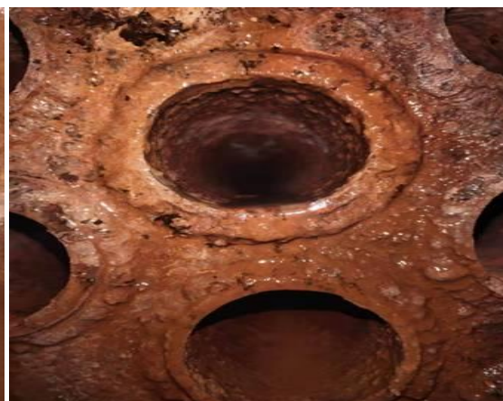
管板处腐蚀烟管漏水
