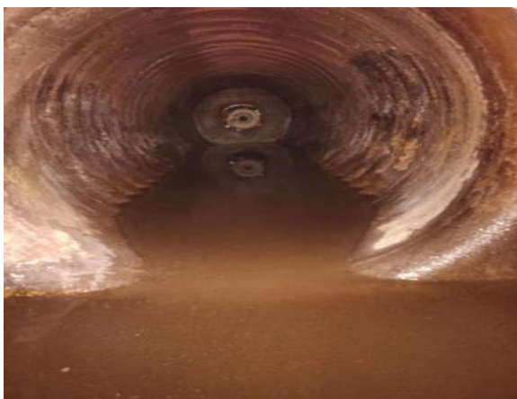
2#锅炉炉膛积水
