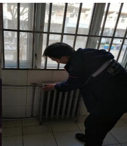
入楼测量温度
