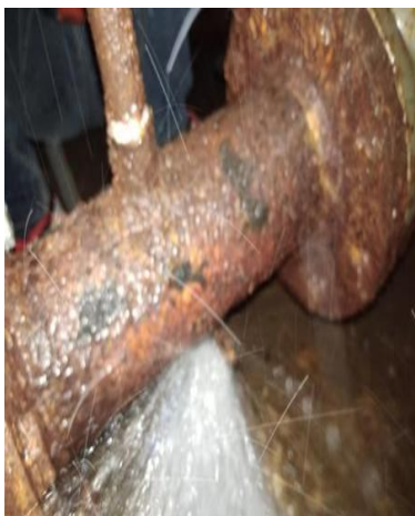
管道锈蚀漏水
