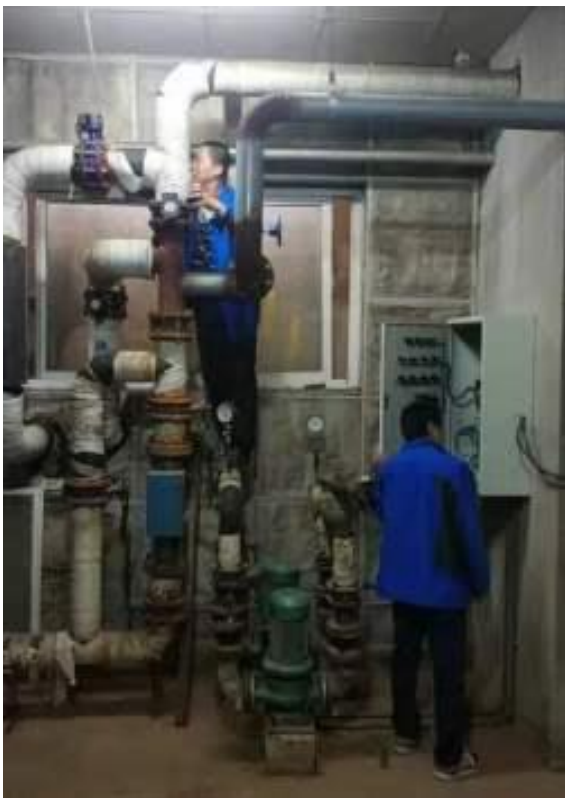
切换太阳能供热模式（起用）
