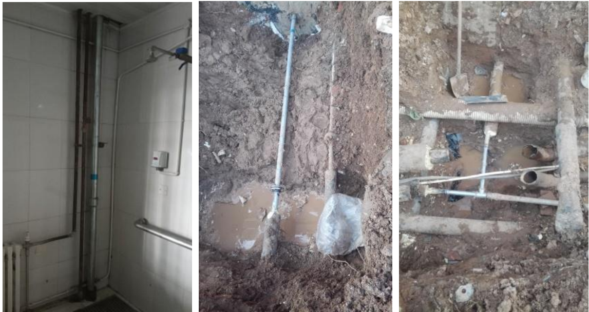
丹枫园 A 浴室管道 静园东洗浴入户管道 静园西洗浴入户管道
