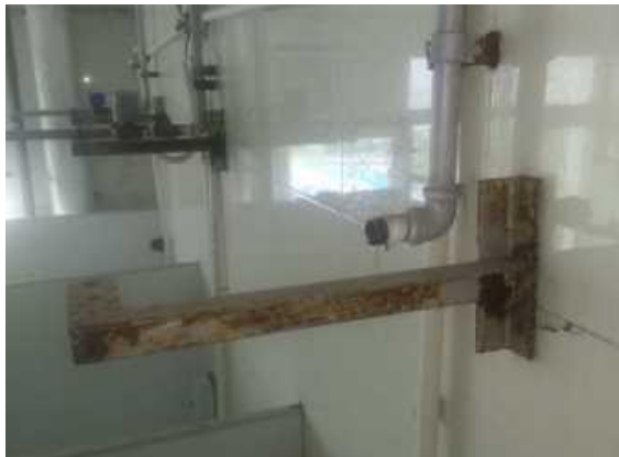
管道腐蚀漏水维修
