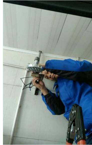
设备故障关闭阀门
