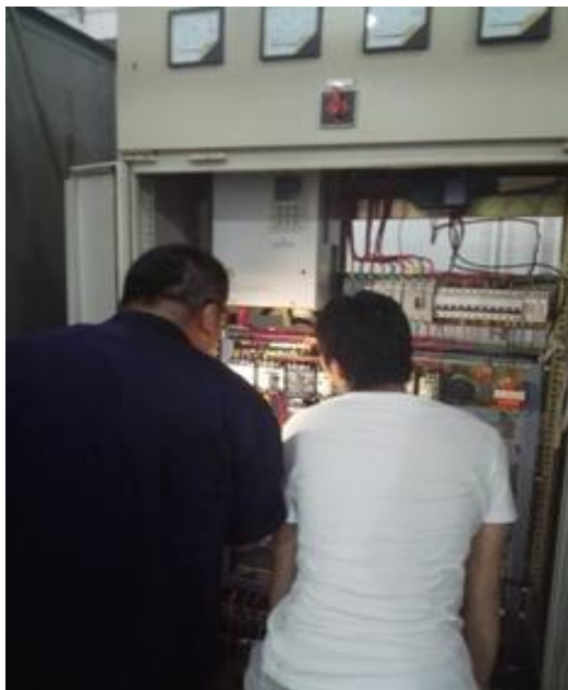
配电柜线路检测
