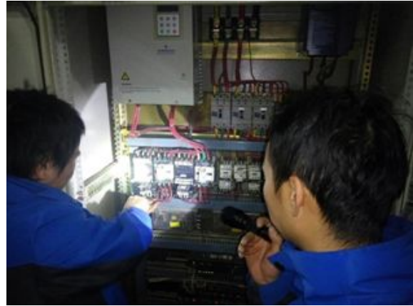
更换 1#交换站供暖控制柜热继
