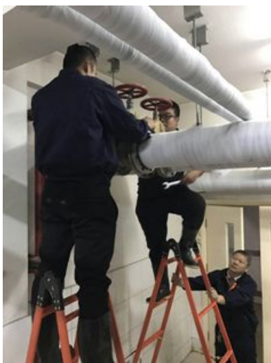
2#食堂总阀门阀芯脱落、更换
