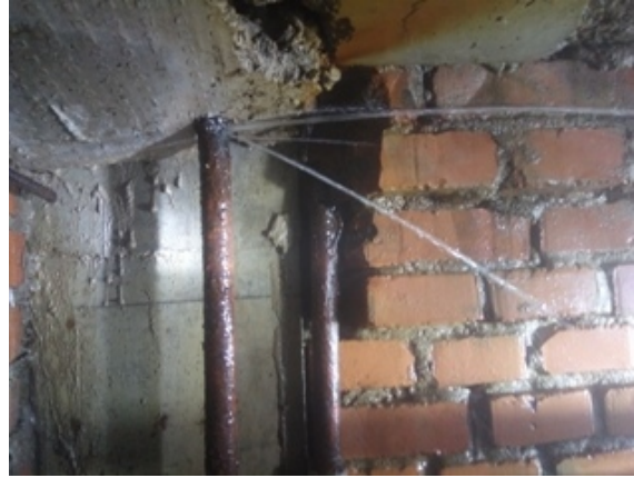
化学楼地沟暖气管腐蚀漏水
