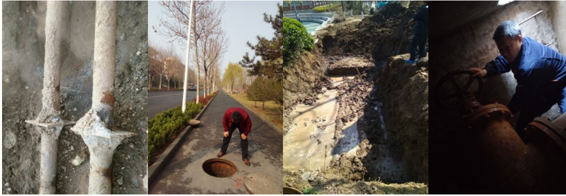
分段关水排查漏水点 球场南边井下查找漏水点 西篮球场管道井查找漏水点
