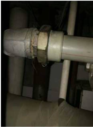
静园 B 浴室顶棚热水管漏
