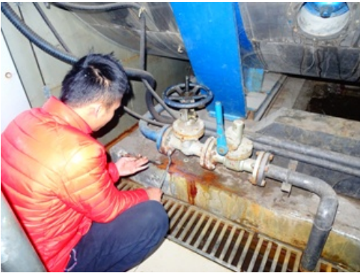
锅炉排污阀故障，不能排污
