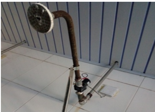
损坏的淋浴喷头
