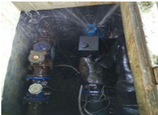
暖气阀门井法兰漏水
