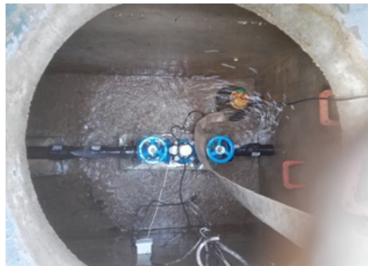
节能平台中水井管件漏水
