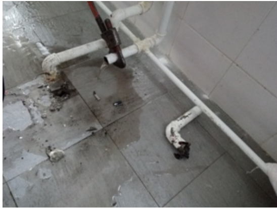
北食堂管道腐蚀
