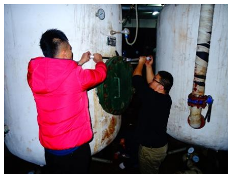
静园换热罐漏水抢修
