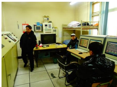
苏主任巡查锅炉控制设备
